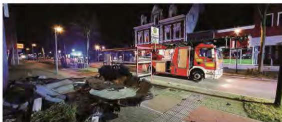
Ein Sturm reißt am 18. Februar Teile des Dachs vom Gebäude der Gaststätte Neuhaus und schleudert sie quer über die Scherlebecker Straße auf den Gehweg. FOTO BERGMANNSHOFF
