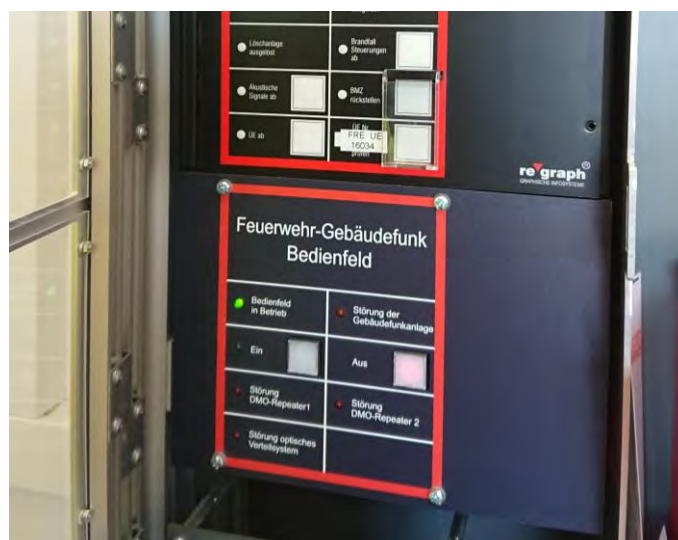
Bsp.: Bedienfeld Gebäudefunk
