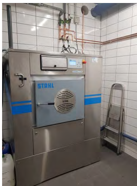
Beladebereich der Waschmaschine im „Schwarzbereich“
