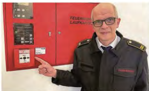
Feuerwehrchef Stefan Lammering zeigt den Brandmelder. Beim Öffnen des Gehäuses ging der Alarm unbeabsichtigt los – eine Viertelstunde früher als geplant.
