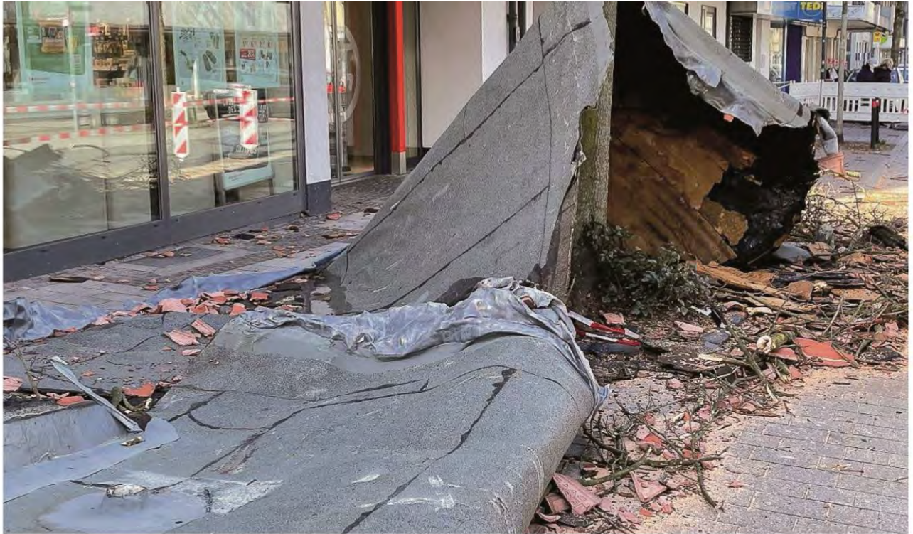
Rund 100 Quadratmeter Dachfläche hat der schwere Sturm am Freitagabend von dem Haus an der Westerholter Bahnhofstraße gerissen, in dem sich die Drogerie Rossmann befindet.
