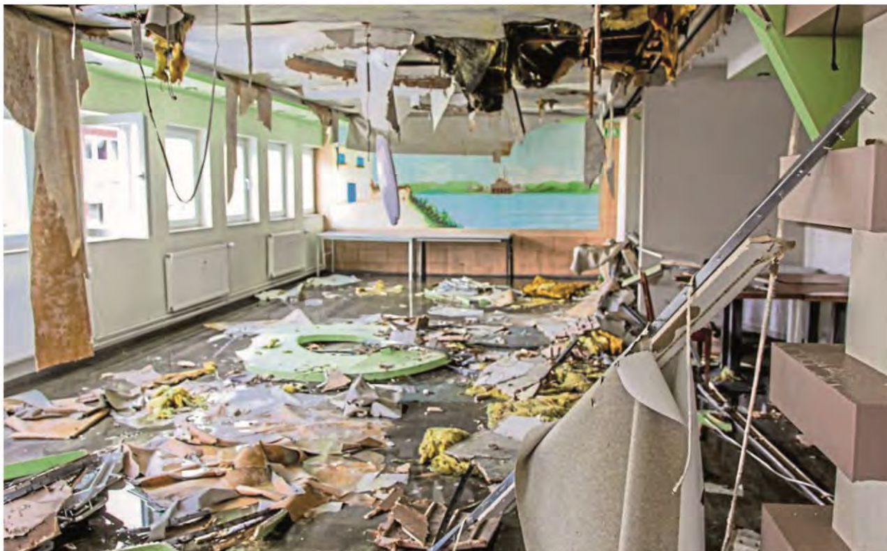
An der Langenbochumer Straße ist ein Fernwärme-Rohr geplatzt und hat eine Zwischendecke aufgerissen.
