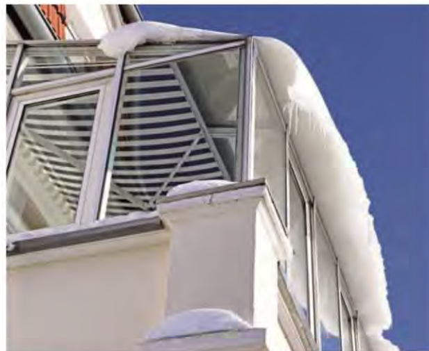
Ein Schneebrett an einem Gebäude an der Theodor-Heuss-Straße in Hertens-Mitte. Absperren und Warnhinweise aufstellen – das sind deutlich gesündere Alternativen, als zurzeit selbst aufs Dach zu steigen.
