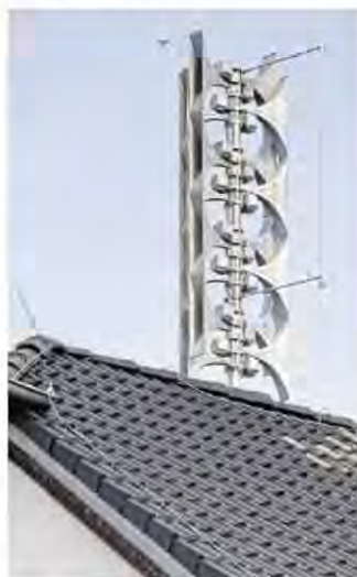
Sechs Sirenen gibt es aktuell in Herten – wie diese bei den Hertener Stadtwerken.
