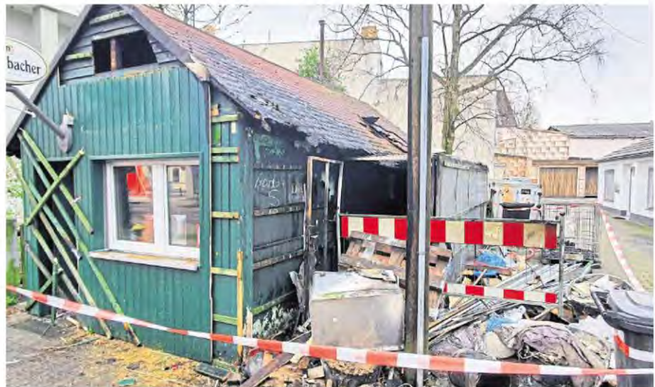
Die „grüne Bude“ in Langenbochum ist gestern Morgen durch ein Feuer schwer beschädigt worden.
