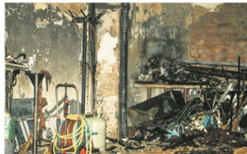
Ein Blick in den ausgebrannten Lagerraum: Die Hitze ließ den Putz abplatzen, unten steht eine Gasflasche.
