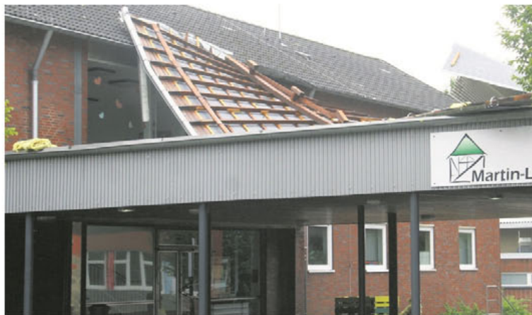
An der Martin-Luther-Schule hat der Sturm das Dach des Verbindungsganges zerstört. Metallbleche flogen samt Holzlatten und Teerpappe über den Hof. —FOTOS: BERGMANNSHOFF
