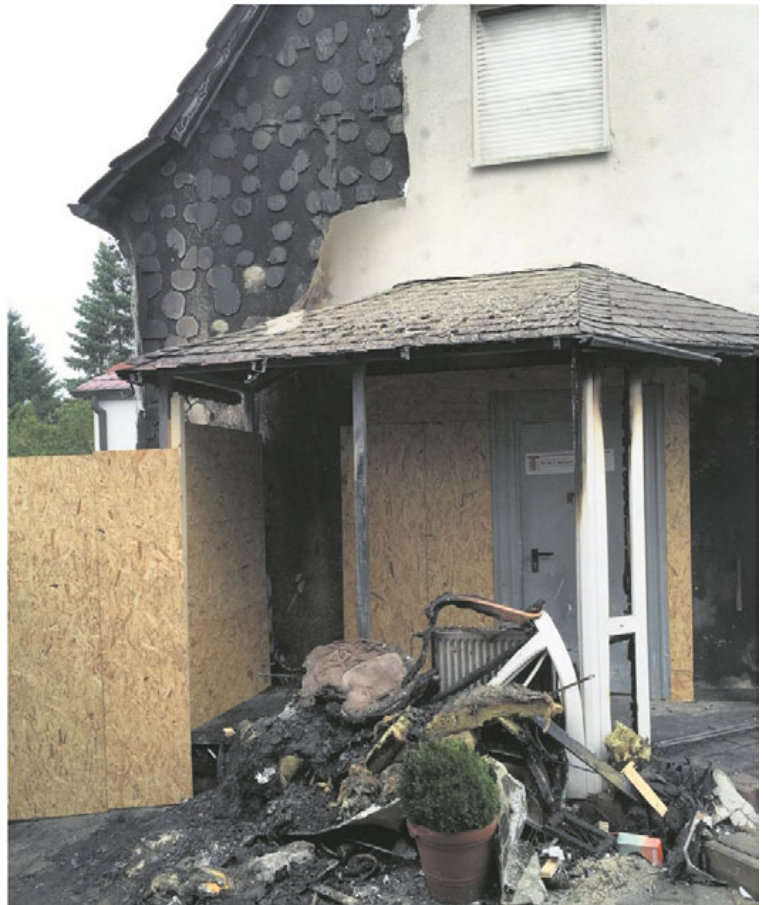
Am Tag danach: Der Schaden ist immens, Windfang und Haustür sind zerstört. Die Fassade ist großflächig verkohlt. —FOTO: CAROLA WAGNER
