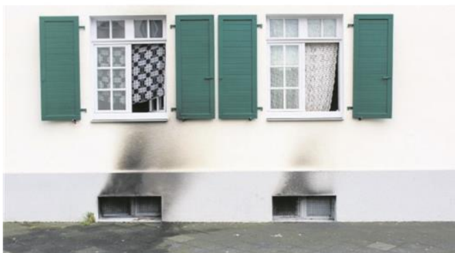
Rußspuren an der Fassade des Hauses an der Zwischenstraße, wo es im Keller brannte. —FOTO: BUDSCHUN
